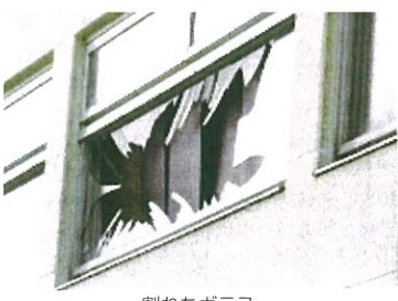
割れたガラス
